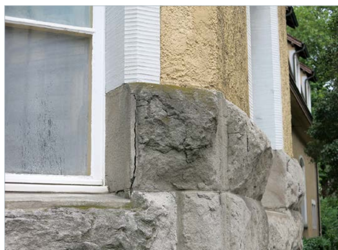
Die Investitionen der städtischen Gebäude werden von Jahr zu Jahr hinaus geschoben (Im Bild das sanierungsbedürftige Moosmattschulhaus)
